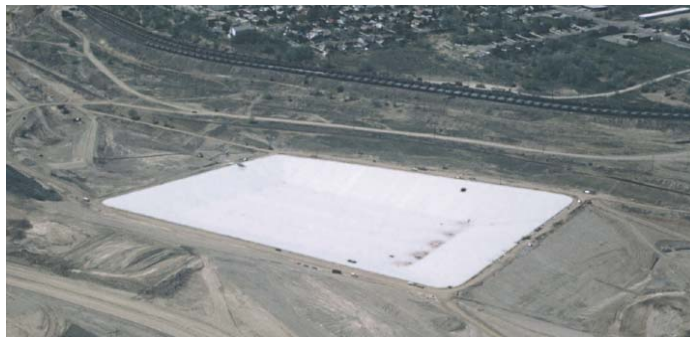
美国内华达州一个矿山的冬季径流池，使用了GSE Conductive White白色导电土工膜。
